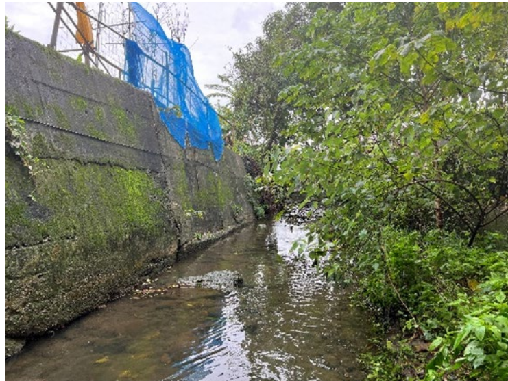
河道淤積處長有植生
