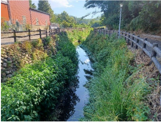
兩側混凝土鋪面植被於裂縫生長
