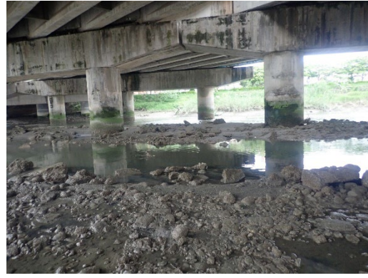
出海口泥沙淤積嚴重，水色混濁
