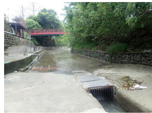
末端水體引流至在槽式礫間淨化設施
