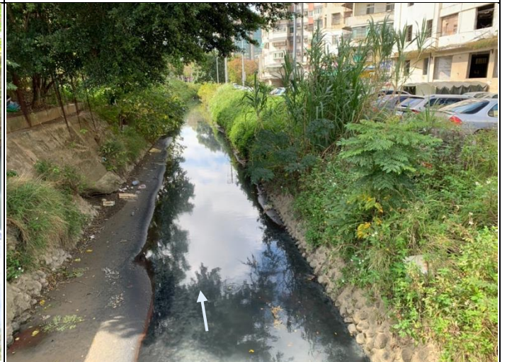
說明：圖 4-赤土崎公園附近右岸僅有低水護岸， 其上為部分土坡 日期：2022.01.19
