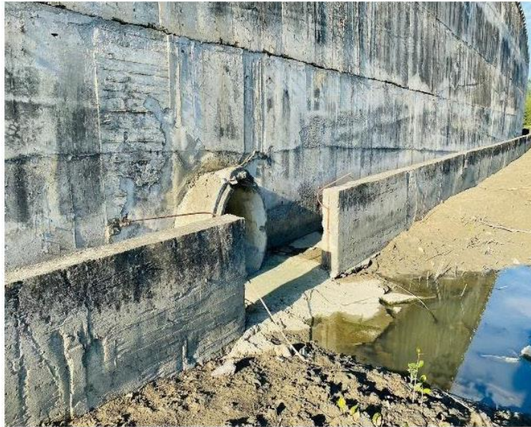
圖 33、涵洞前集水溝與樣區間高低落差
