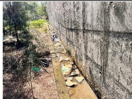
臨高架橋排水溝遭受垃圾傾倒問題
